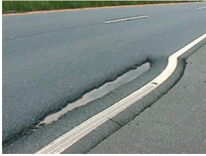
(a) Escorregamento do revestimento (E)
