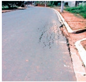
(b) Afundamento por consolidação localizado (ALC)
