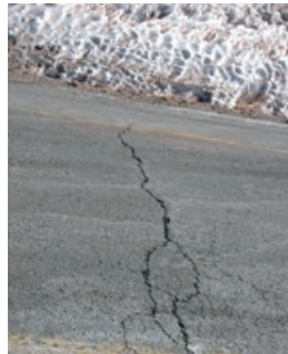
(j) Trinca de retração térmica
