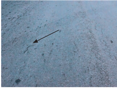
(a) Trincas isoladas curtas longitudinais (TLC)
