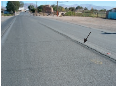
(c) Trinca de retração (TRR)
