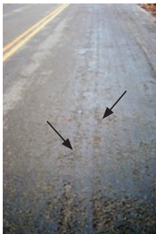
(c) Falha de bico espargidor
