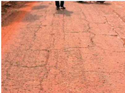
(e) Trincas de bloco com erosão (TBE)
