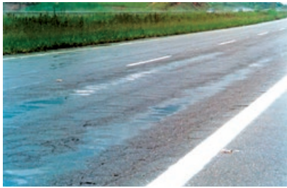
(a) Afundamento por consolidação em trilha de roda (ATC)
