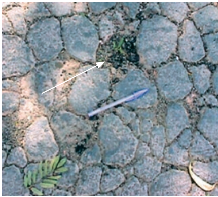
(g) Trincas tipo couro de jacaré com erosão (JE)
