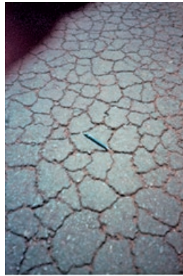
(h) Trincas tipo couro de jacaré (J)
