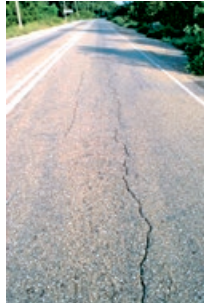
(b) Trincas longitudinais longas (TLL)
