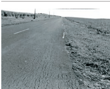
(i) Conjunto de trincas longitudinais longas
