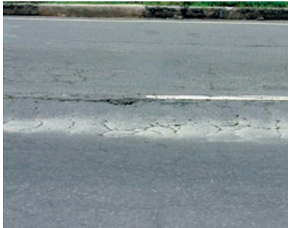
(b) Bombeamento de finos
