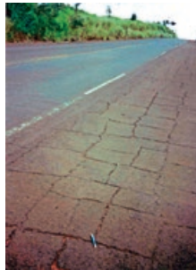
(f) Trincas de bloco sem erosão (TB)
