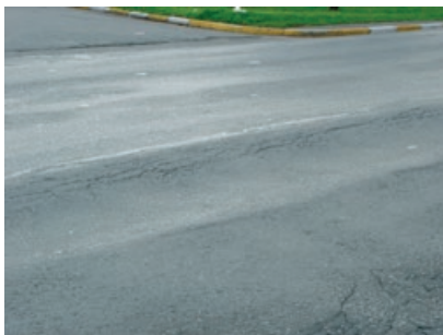
(c) Afundamento plástico nas trilhas de roda (ATP)
