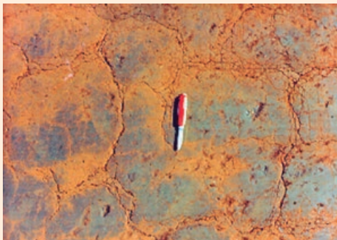
(c) Solo arenoso fino lateritico LA': trincas devido à perda de umidade da camada compactada
