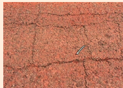
(f) Solo-cal: trincas devido à retração
