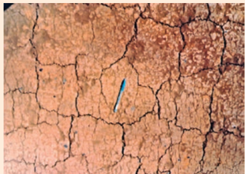
(d) Argila arenosa lateritica LG': trincas devido à perda de umidade da camada compactada
