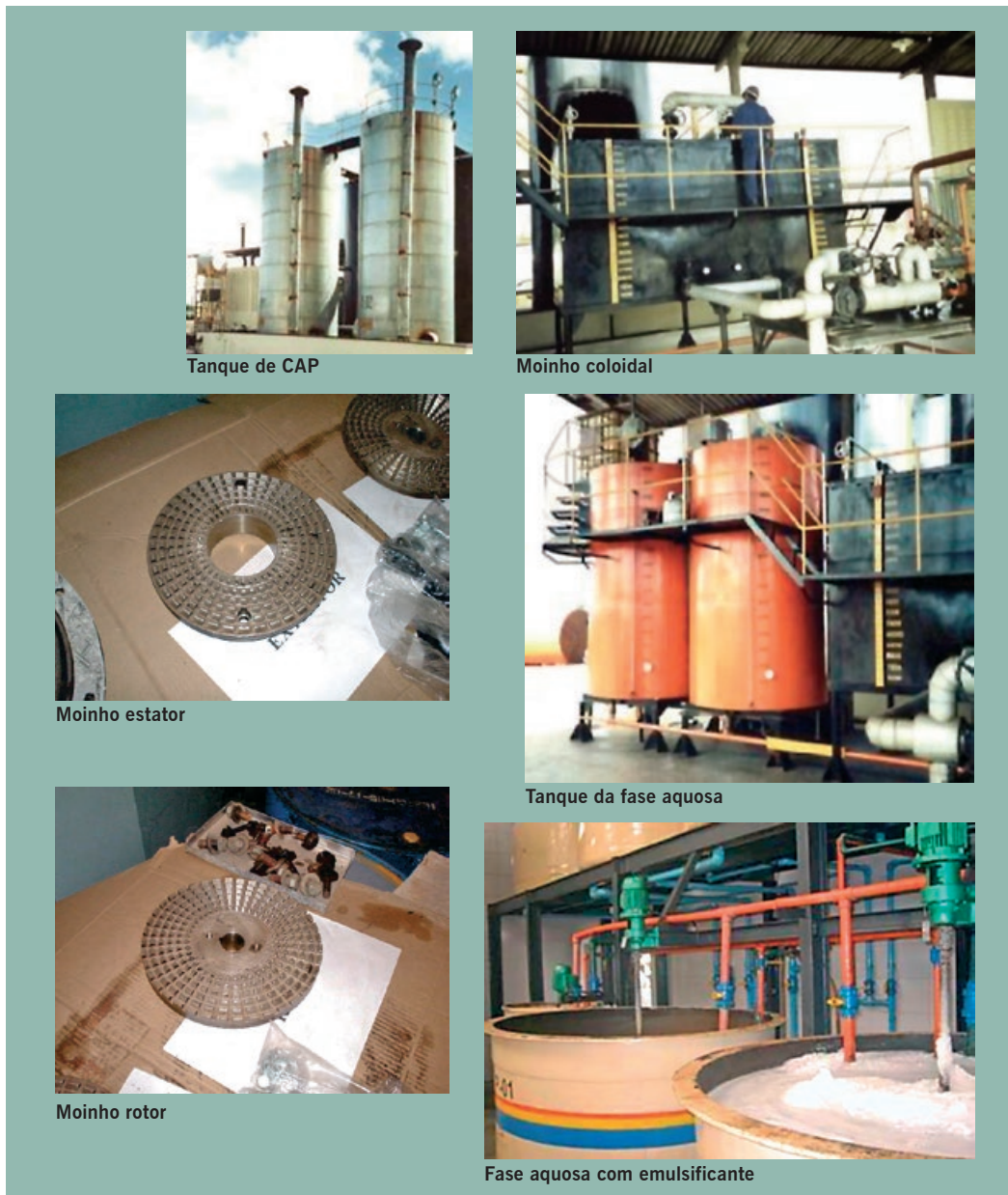
Figura 2.37 Exemplos de várias instalações de uma fábrica de emulsão
