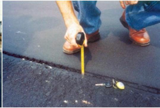
(b) detalhe da espessura delgada do revestimento
