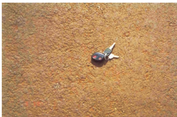
Figura XII.2 – Detalhe da macrotextura do macadame betuminoso com capa selante em via urbana. Execução: 1993
