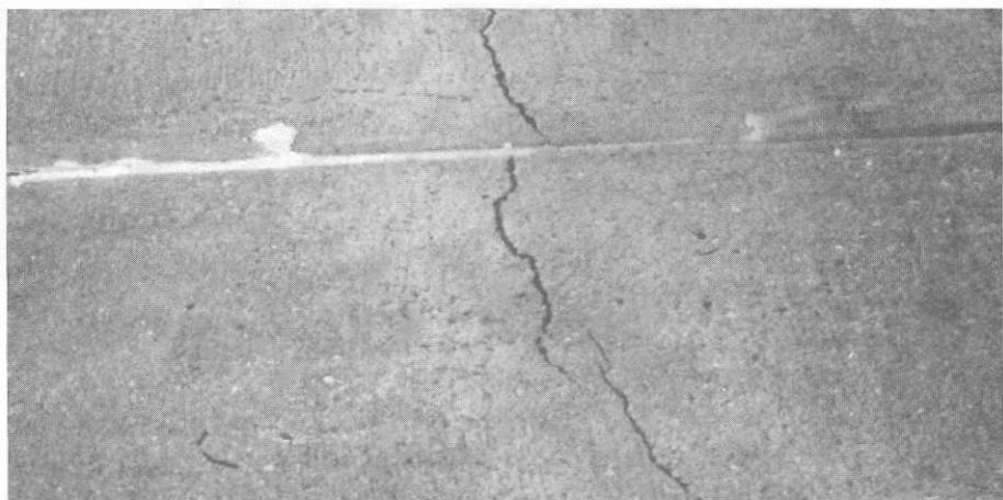
Figura 9.32 Trinca de Restrição.
