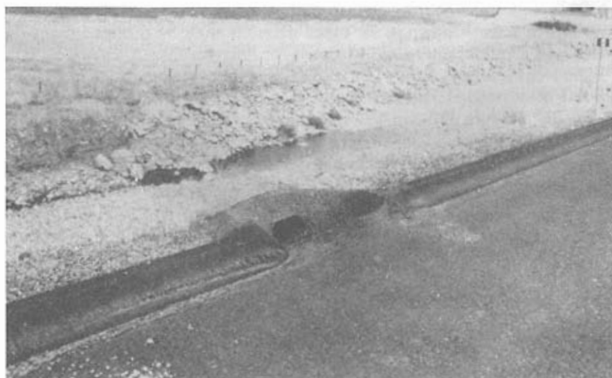
Figura 10.19 Banquetas Dirigidas para a Tubulação de Descarga leva a Carreamento de Água morro abaixo reduzindo manutenção de Valetas e declividades
