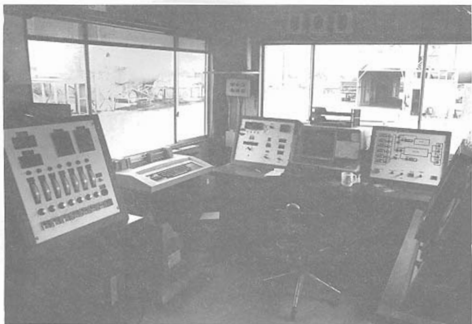
Figura 5.19 Estação de Controle de Instalação Automática
