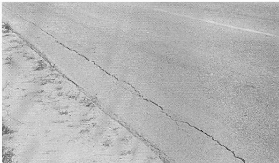
Figura 9.10 Trinca na Borda.
