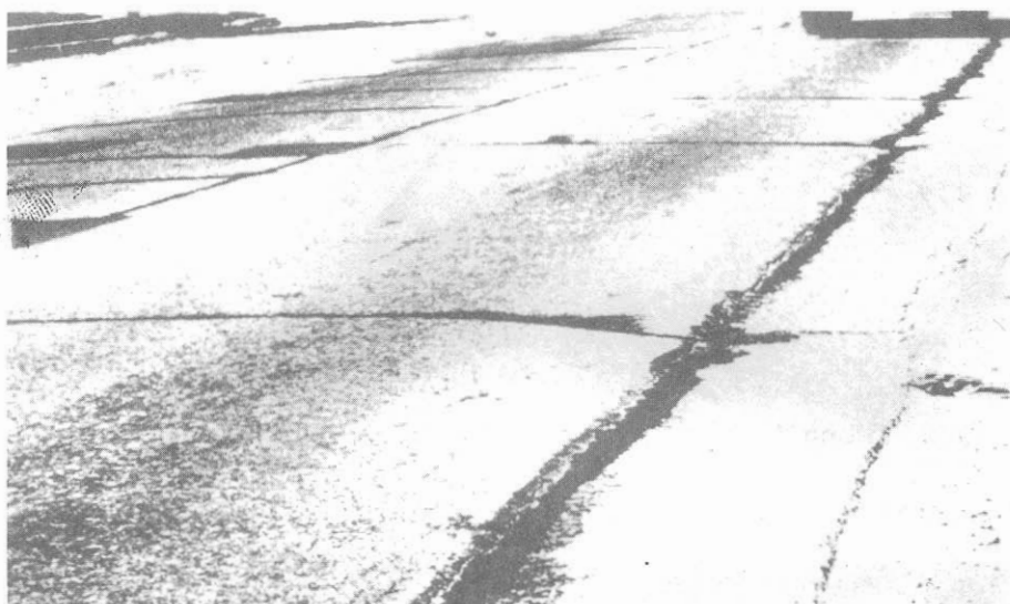
Figura 9.13 Trinca de Reflexão.
