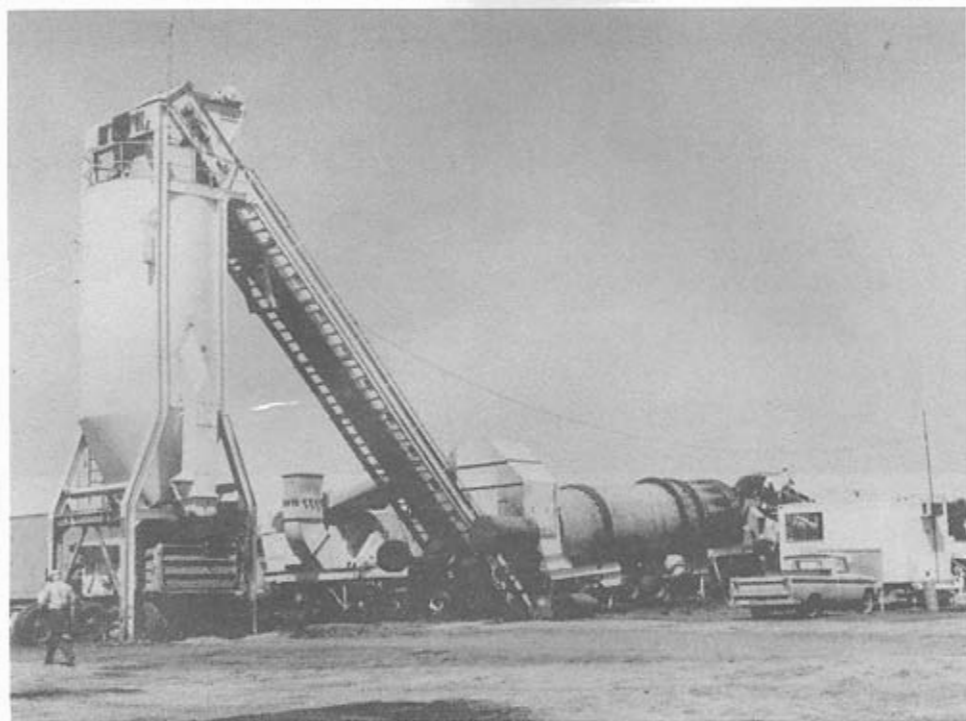
Figura 5.23 Estocagem de Mistura numa Instalação de Mistura de Tambor
