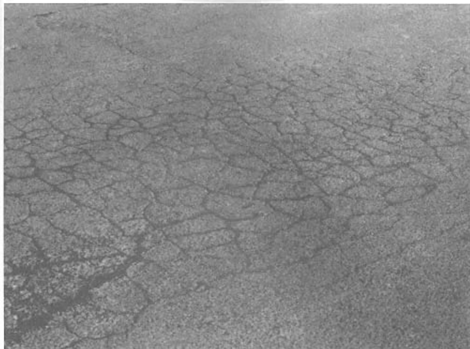
Figura 9.9 Trinca - Couro de Jacaré.
