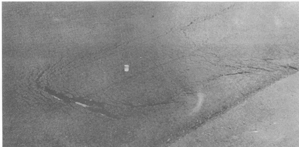
Figura 9.15 Trincas de Escorregamento.
