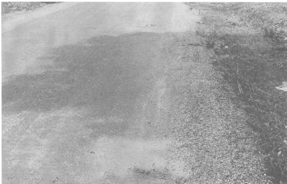
Figura 9.26 Perda de Agregado de Cobertura.
