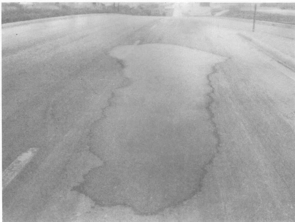
Figura 9.20 Depressões. A Área Sob Depressão é Deliniada Pela Acumulação de Água no pavimento.
