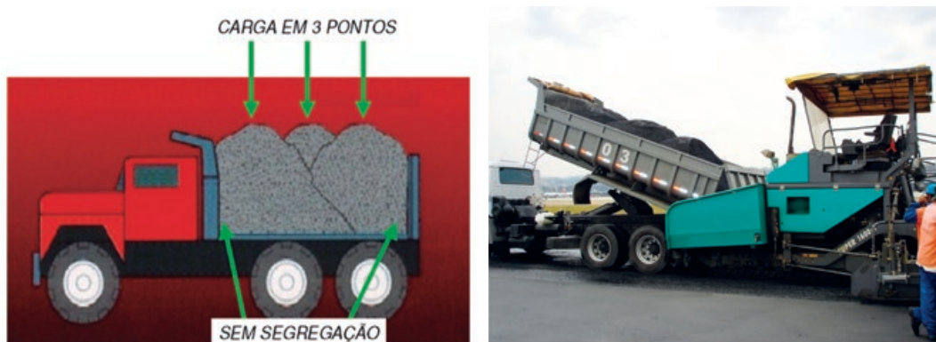
Figura 3.13 Procedimento correto de carga de caminhões na usina e descarga de caminhão com três pilhas de mistura asfáltica dentro da vibroacabadora
